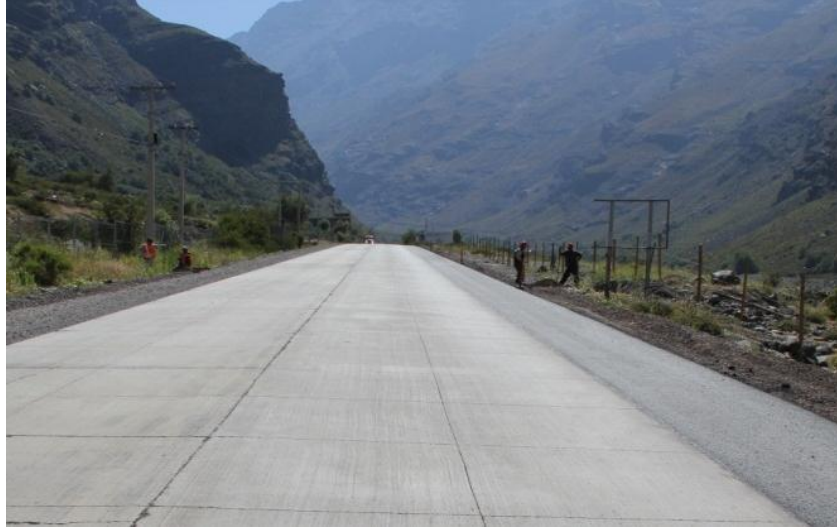
Figura 5. Ruta 78 Losas cortas de 2.00m x 1.75 m en un sector con alto alabeo de construcción.
