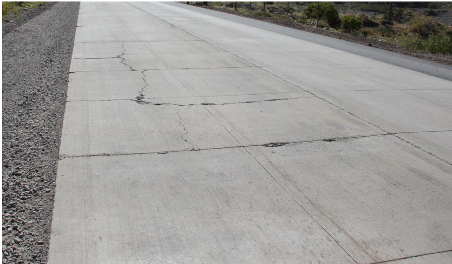
Figura 4. Ruta 60 – 4,5 m largo por 3.5 ancho losas diseñadas por AASHTO 1998, con las losas agrietadas.
